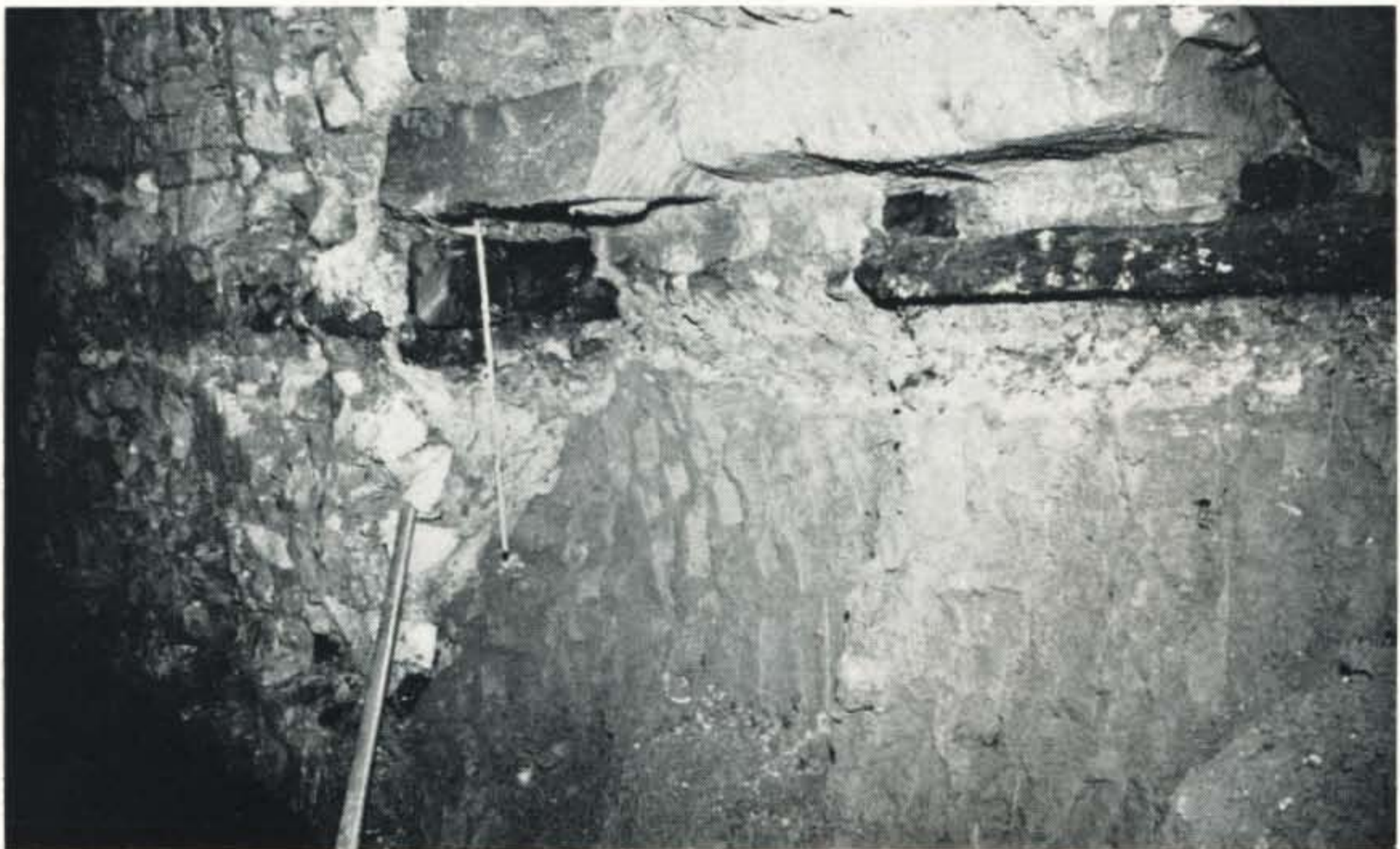
Freilegung eines auf Lößlehm gegründeten Fundamentteiles an der Westseite des Kattenburg=Mittelflügels. Unter den Sandstein-Gründungsplatten stark vermoderte Reste des alten Holzrostes. Links Mauerwerks-Tiefgründung auf Röt. Höhe der oberen Gründungssohle: 142,60 m über NN.
