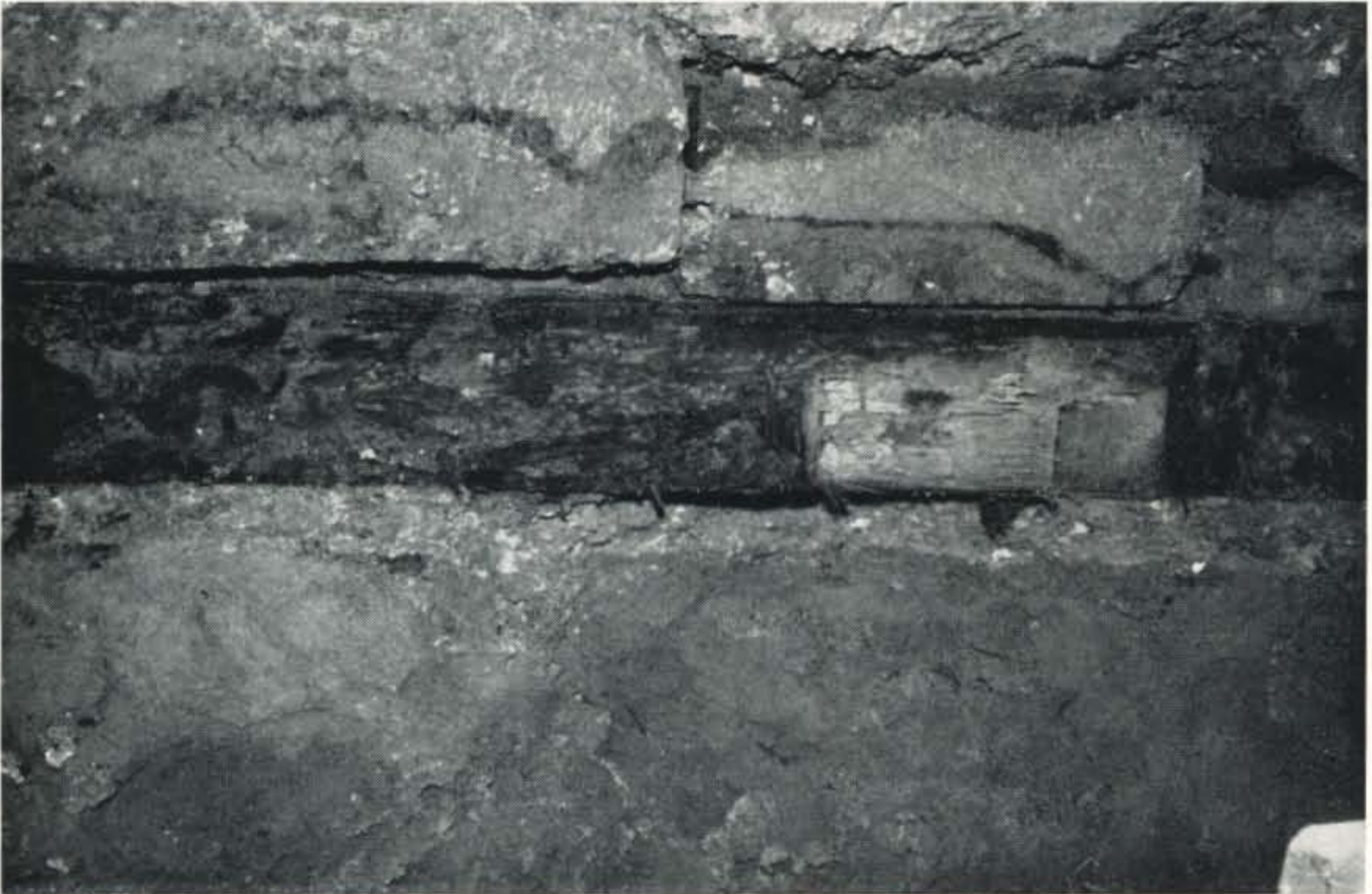
Freilegung eines auf Lößlehm gegründeten Fundamentteiles an der Westseite des Kattenburg=Mittelflügels. Unter den Sandstein-Fundamentplatten eine gut erhaltene Eichenholzschwelle. Höhe der Fundamentsohle: 141,50 m über NN.
